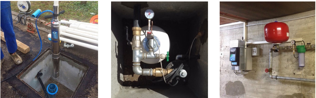
Fig. L-M, Particolare di un pozzo artesiano completamente interrato e servito da una pompa sommersa (a sinistra) e locale tecnico con gruppo di filtrazione e pre-filtrazione (a destra).
